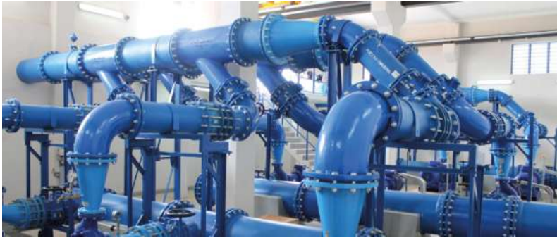
Une station de pompage d'un Système d'approvisionnement en eau potable multi-villages au Bénin
